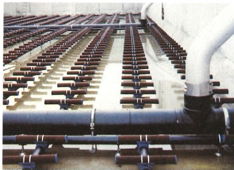
Belüftungssystem in Klärbecken aus SIMONA® PE-HD-Rohren
