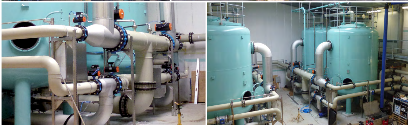
Rohrleitungssystem aus SIMONA® PP-H AlphaPlus® für eine Brunnenwasseraufbereitungsanlage (Belüfter, Enteisenungs- & Entmanganungsfilter) zur Trinkwasserversorgung
