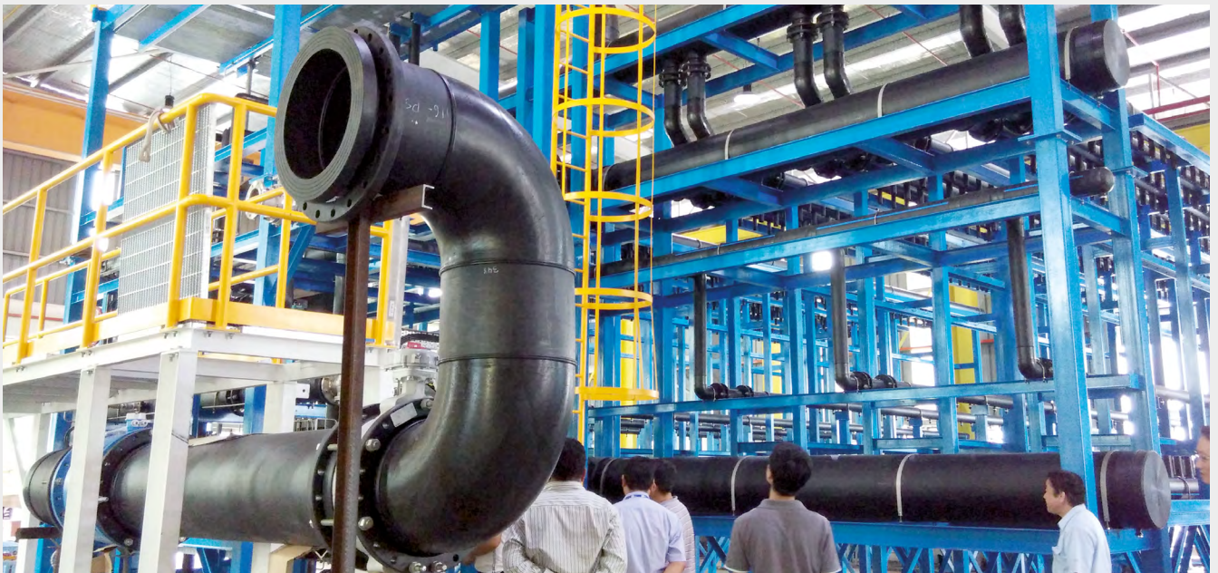
Changi II NEWater Plant in Singapur ausgestattet mit SIMONA Rohren und Formteilen.
